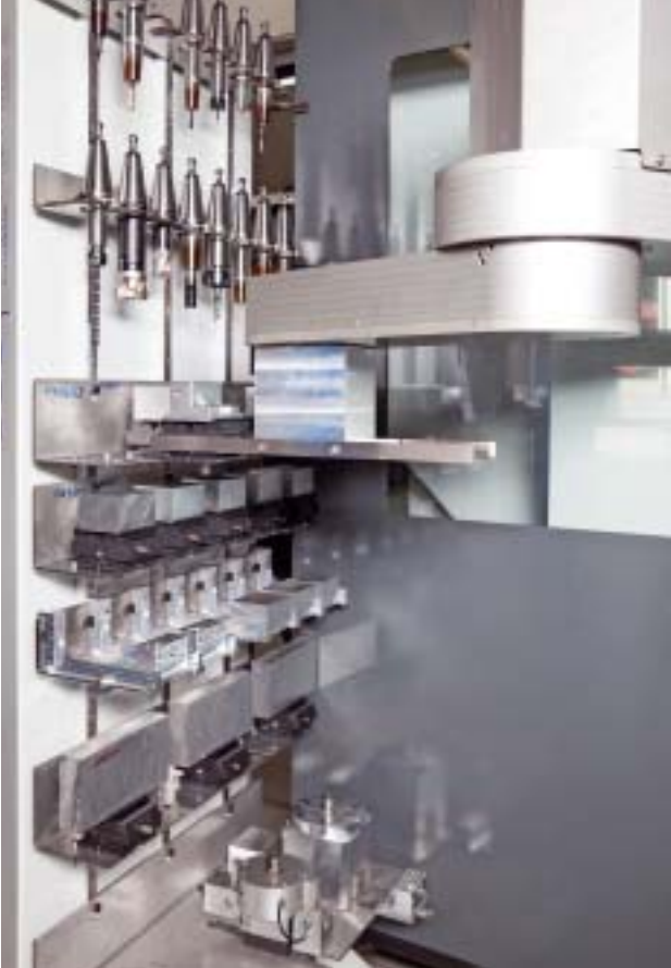
Werkzeuge, Werkstücke, Spannmittel und Wechselgreifer für den Roboter finden in den Regalmagazinen Platz. Die Aufnahmen lassen sich bei Bedarf auch verschieben.
